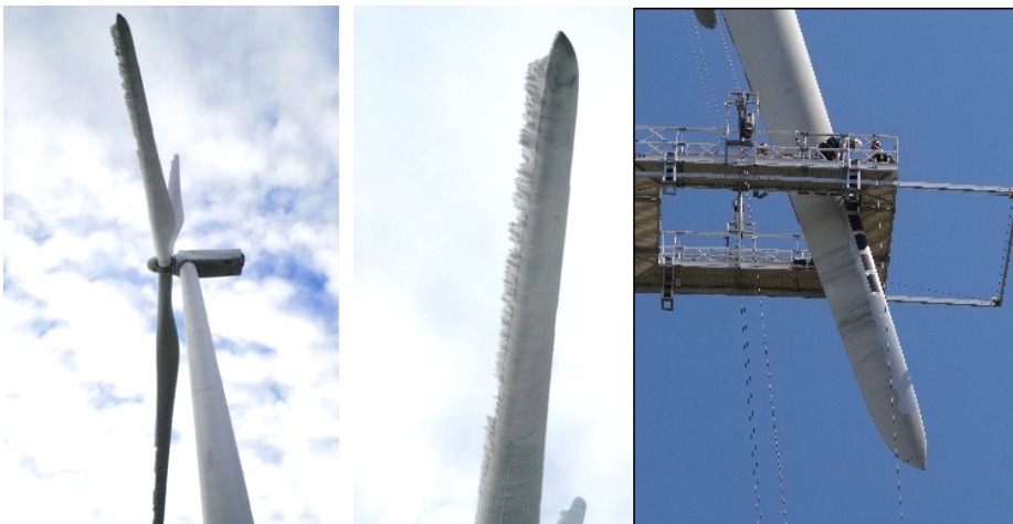
Figure 1 : éoliennes fortement givrées (à gauche) ; installation du système de dégivrage (à droite)
